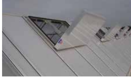
Einbaugeräte im Satteldachlichtband
