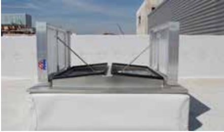
Einzelgerät auf Sockel auf einem Industriedach
