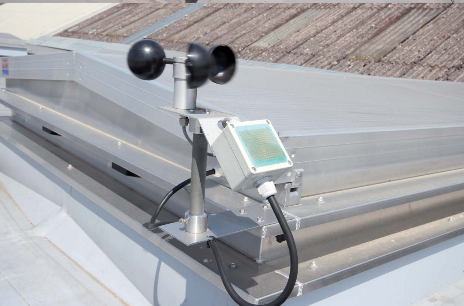
Ein Wind- Regensensor schließt die Systeme bei einsetzendem Regen automatisch.
