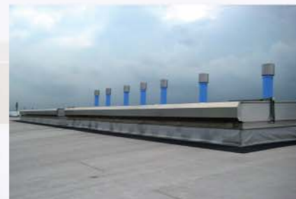
AIRSTAR auf einem Kraftwerk
