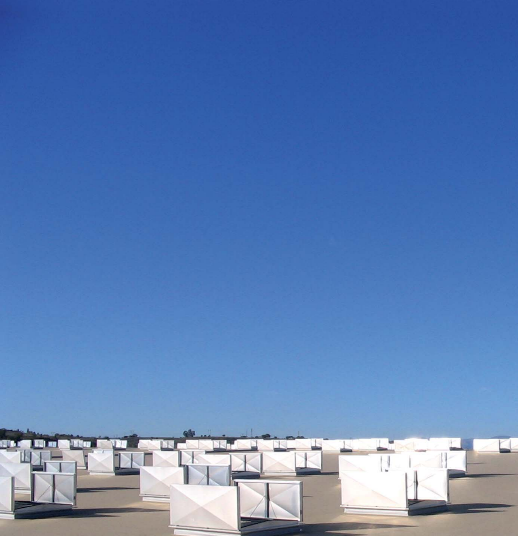
Großes Bild: Lüftungsgeräte Typ PHÖNIX auf dem Dach einer Industriehalle
