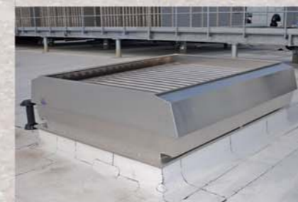
Einzelgerät auf einer Montagehalle
