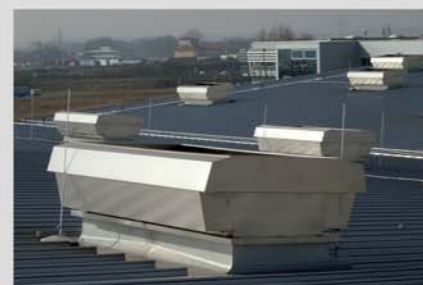
Einzelgeräte auf einer Industriehalle
