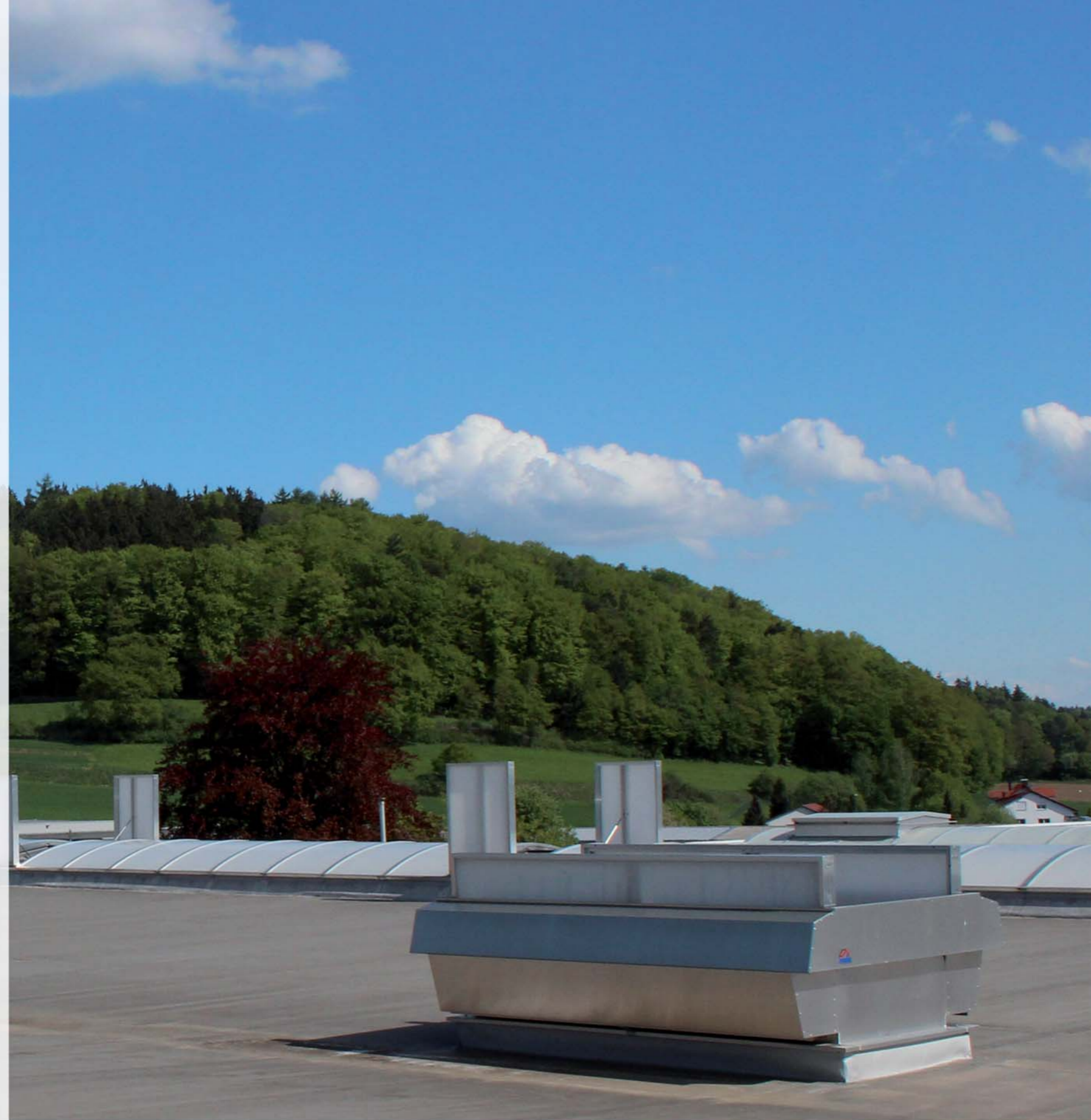
Großes Bild: MEGAPHÖNIX als Einzelgerät auf einer Industriehalle
