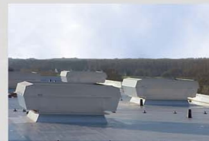
Gewährleisten Lüftung auch bei Regen
