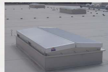
Einzelgeräte auf einem Industriedach
