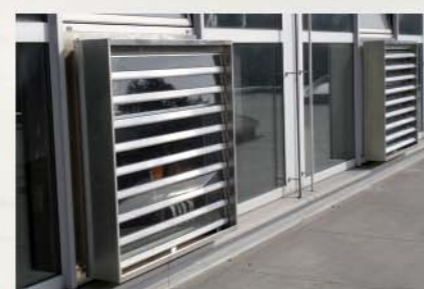
Mit Isolierglas ausgefachte SMOKEJETs
