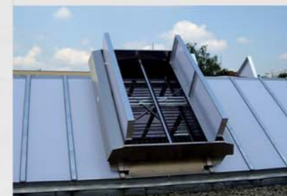
In ein DELTALIGHT integriertes Gerät
